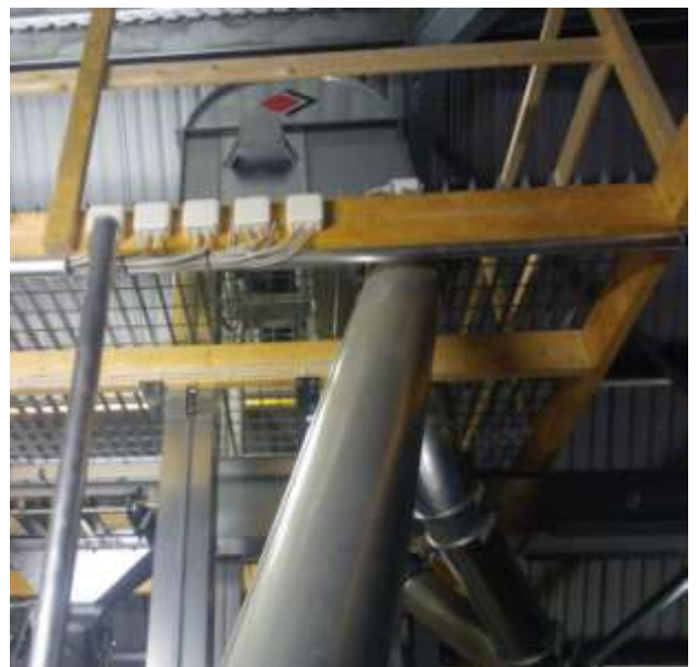
Elevaattorin huoltotaso ja johdotuksia
